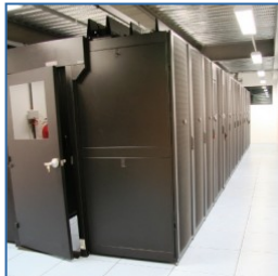
Datacenter de Cheops Technology à Bordeaux
