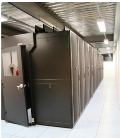
Datacenter Cheops DR
